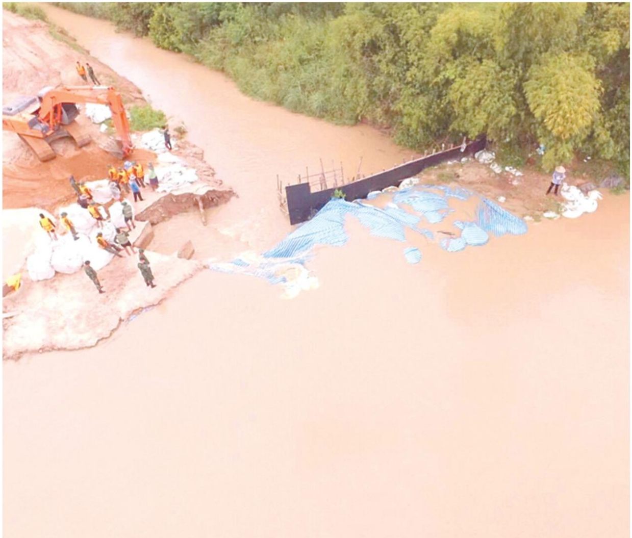
●กั้นน้ำทะเล็ก...กรมชลประทาน ร่วมกับกองทัพบกและองค์กรท้องถิ่น ระดมกำลังซ่อมแซมจุดกั้นน้ำทะเล็ก (Big Bag) ป้องกันน้ำทะเล็กเข้าท่วมพื้นที่การเกษตรกว่า 1,000 ไร่ หลังเกิดฝนตกหนักส่งผลให้เกิดน้ำป่าไหลหลากลงสู่ลำห้วยหลายแห่ง โดยเฉพาะคลองม่วง บริเวณปากคลองชม จ.นครสวรรค์ ที่มีระดับน้ำเพิ่มสูงขึ้นอย่างต่อเนื่อง
