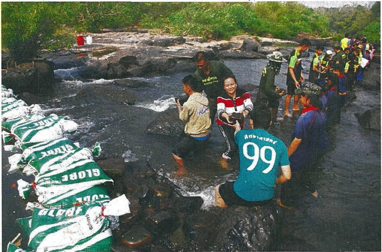
สร้างฝายชะลอน้ำ : ชาวชน ชาวบ้านและทหาร ร่วมสร้างฝายชะลอน้ำลำน้ำเข็ก กักเก็บน้ำไว้อุปโภคบริโภค ที่ ต.แก่งเส็ก อ.วังทอง จ.พิษณุโลก
